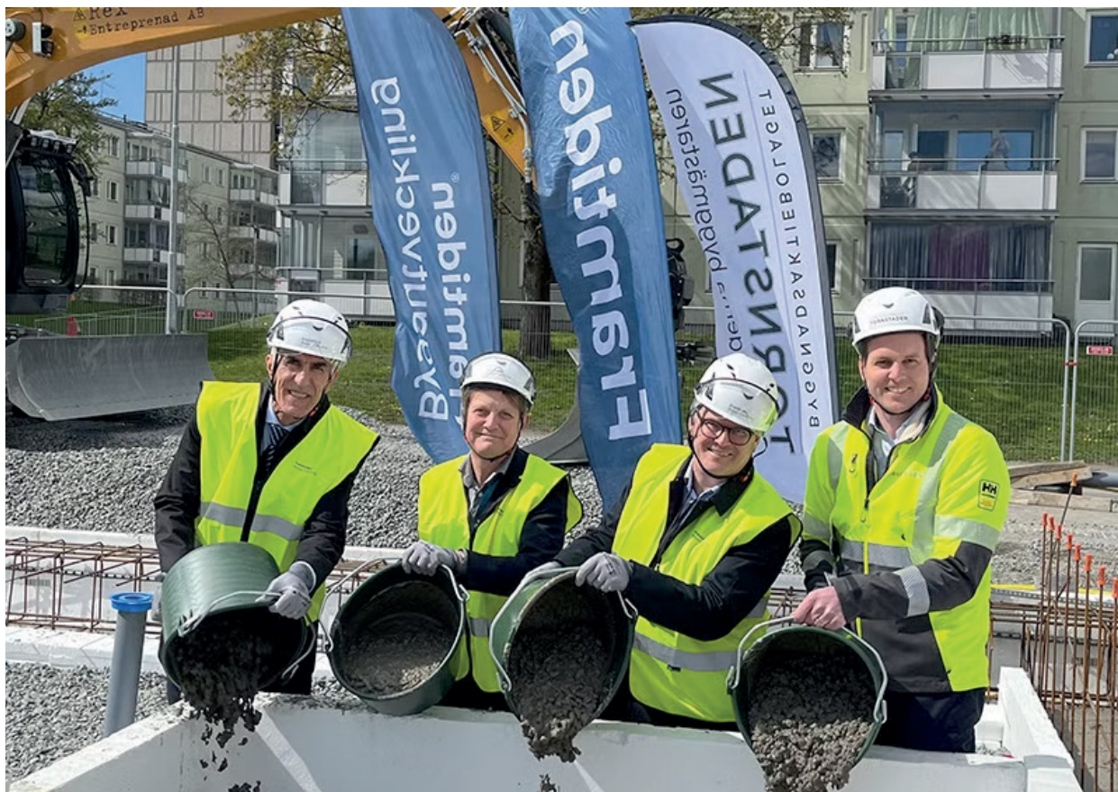
En gjutning görs i kvarter 6 i Selma stad av Aslan Akbas, Framtiden, Terje Johansson, Framtiden, Dan Sandén, Framtiden Byggtutveckling och Jon Blomberg, Tornstaden. Bild Selma stad.
